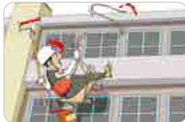
달비계를 사용하여 건물 외벽 청소에 구명줄 미설치
